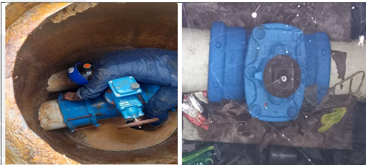
Ilustración 1: daños y reparaciones simultaneas en red de acueducto de conducción norte de 10 y 12 pulgadas instalada entre la tanque 0 y tanque 2 Fecha 22/02/23 - Fuente: Aguas Mocoa
