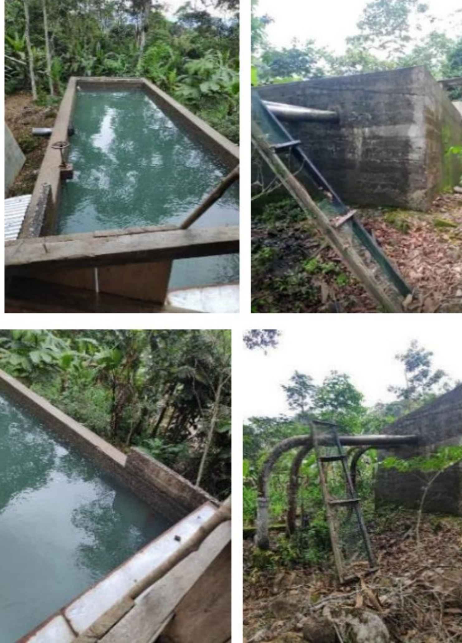
Fotografía 8. Desarenador Sistema Líbano
