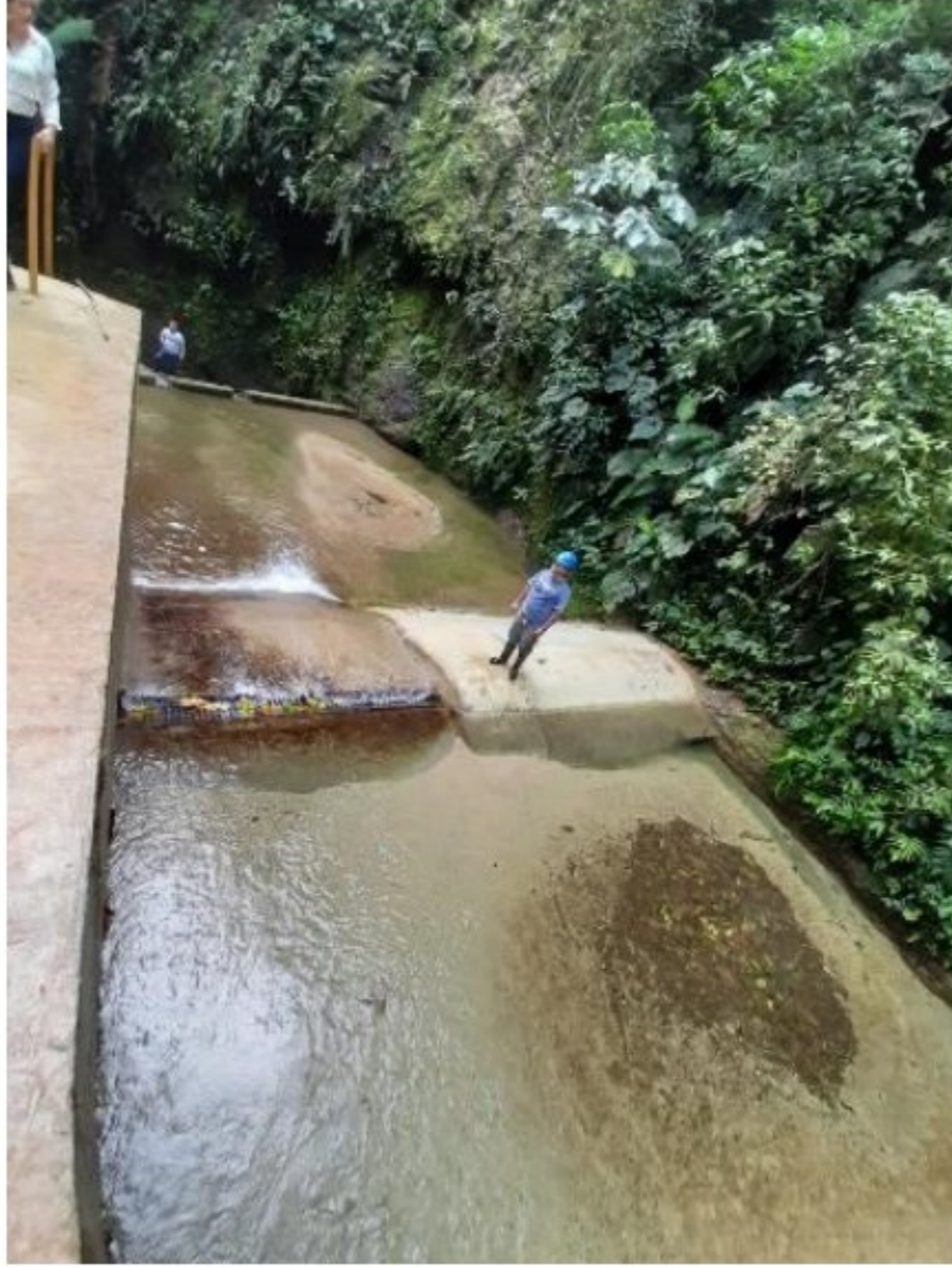
Fotografía 19. Estado de la bocatoma Q. Chontayaco
