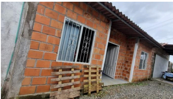
Foto 1: Se evidencia una estructura de pared relativamente nueva en obra negra, de ladrillo fresco.
