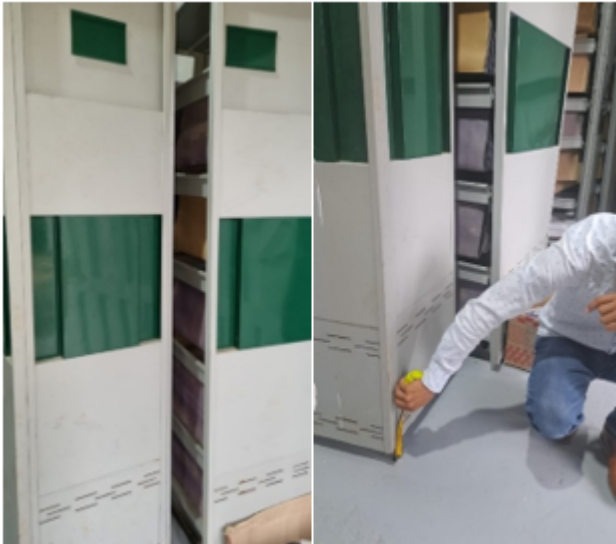
Foto 9: La altura de la primera balda está a 10 cm del piso, la altura total de la estantería es de 2 metros. Los estantes tienen corrosión en la parte baja debido a falta de mantenimiento.
